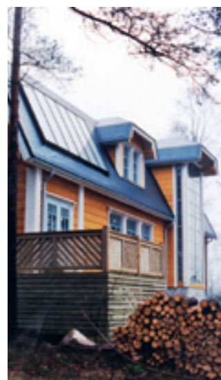
Aurinkokeräimet hyödyntävät auringonsäteilyn ja muuttavat sen lämmöksi. Kuva Motiva/Mika Kanerva.
