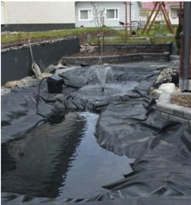
Allaskumi on paikoillaan. Suihku ja suodatin toimivat.
