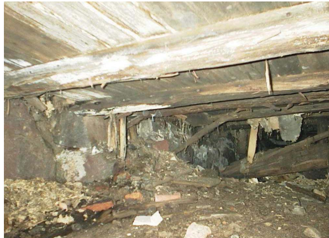
Alapohjan puutteellinen tuuletus johtaa alapohjarakenteiden lahovaurioihin.
