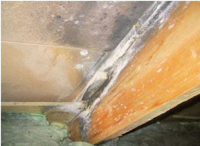
1970 ja -80 luvuilla rakennettujen ns. käkikellotalojen yläpohjat ovat tyypillisesti puutteellisesti tuulettuja. Tämä johtaa home ja kosteusvaurioihin.
