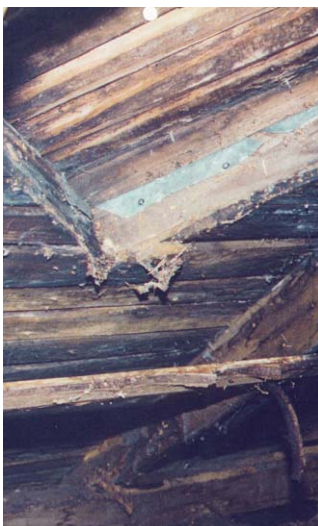
Pitkään vuotanut vesikatto on tehnyt tehtävänsä katteen aluslaudoituksessa.
