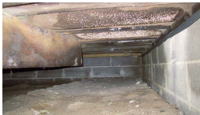
Maasta nouseva kosteus on kastellut harkkoperustuksen, ja home on vallannut alapohjan.
