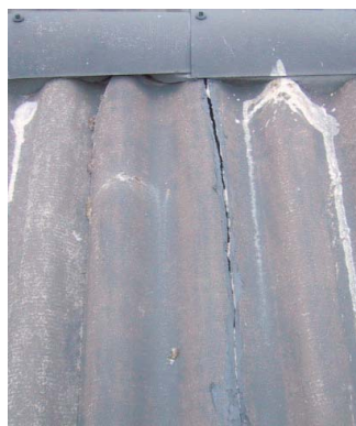
Halkeaman ovat tyypillisiä vanhojen kuitusementtikatteiden vaurioita.
