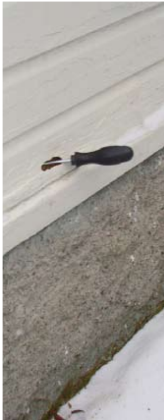
Tiivis maalipinta ja seinän tuuletusvälin puute sekä sokkelista nouseva kosteus ovat johtaneet seinän lahovaurioon.
